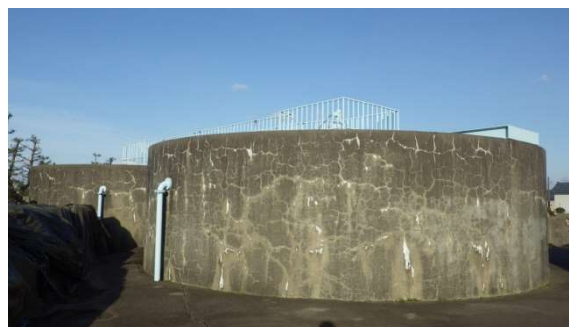
吉田浄水場 濃縮槽
