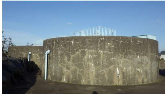
吉田浄水場 濃縮槽
