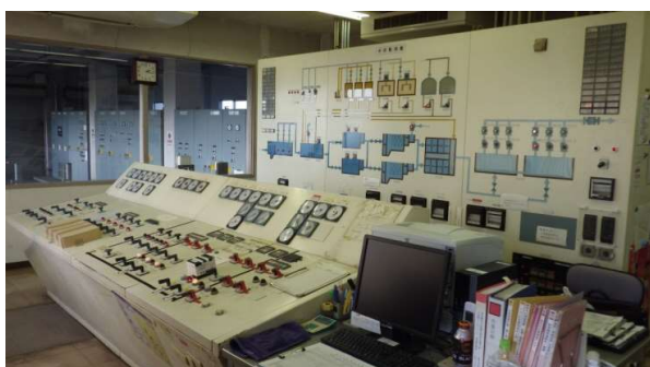
分水浄水場 中央操作盤
