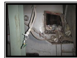
〔計器類・点検口の破損〕
