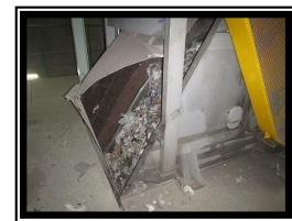
〔設備外装の破損〕
